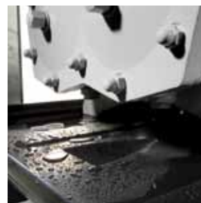
Вода, удерживаемая уплотнительными прокладками, и дренажная вода автоматически улавливаются и отводятся посредством системы перегородок.
